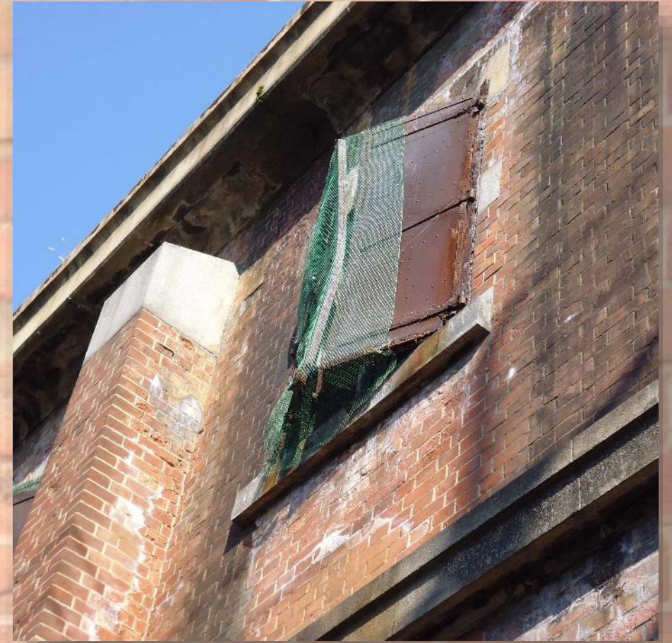
爆風で変形した鉄扉 平成25年撮影
