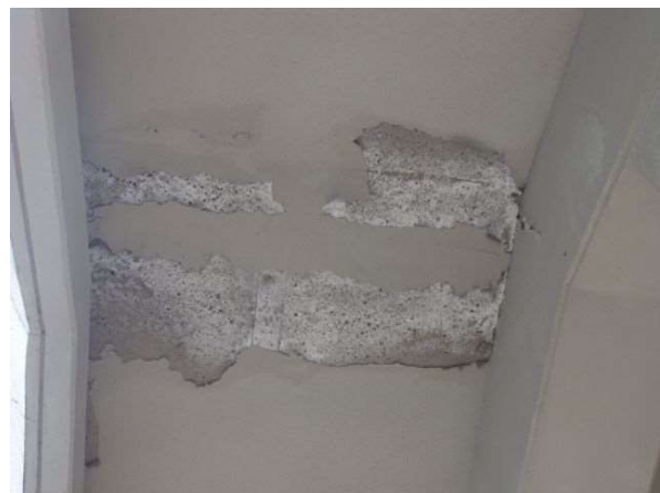
陸上競技場天井化粧の剥離
