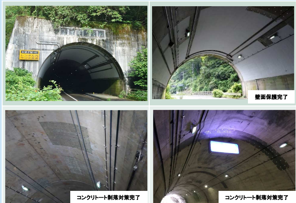
八丁トンネル(大竹市 小方町 八丁)
