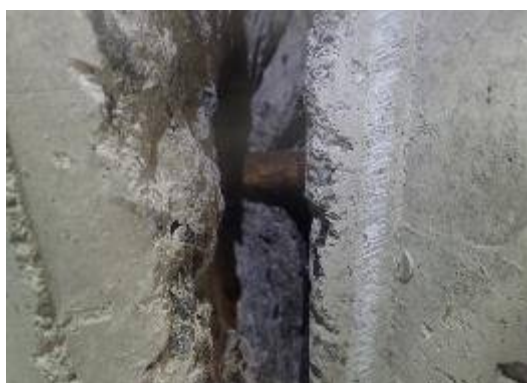
覆工アーチ部のはく落・鉄筋露出
