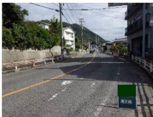
路面の損傷（ひび割れ）
