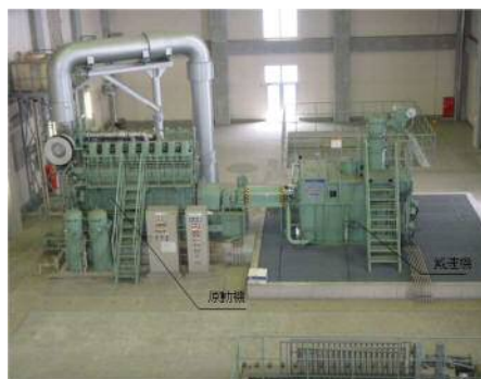
【主原動機・減速機(手城川排水機場)】
