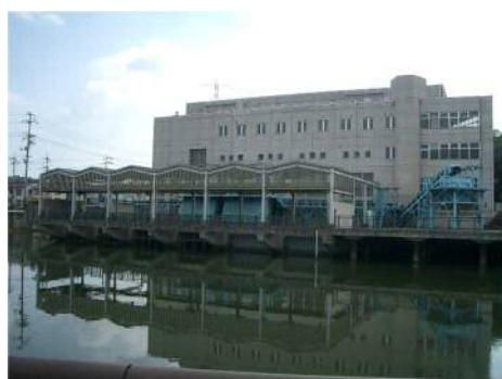
【手城川排水機場】
