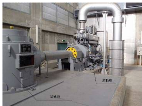
【主原動機・減速機(岡ノ下排水機場)】
