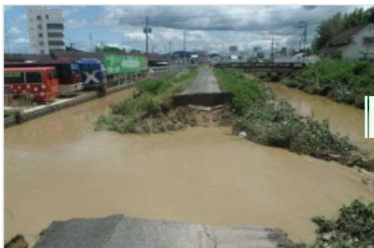
猪之子川（左岸）破堤 H28. 6. 23
