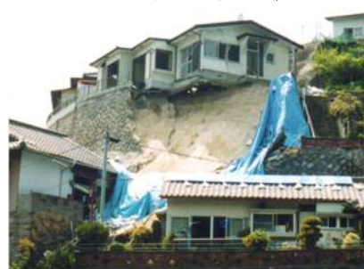
▲呉市で発生した宅地擁壁の崩壊
