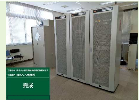
梶毛ダム管理用制御処理設備 (修繕後)(広島市佐伯区)
