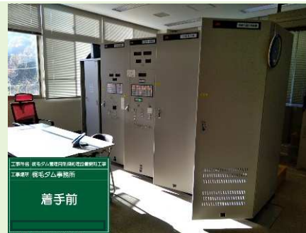
梶毛ダム管理用制御処理設備 (修繕前)(広島市佐伯区)
