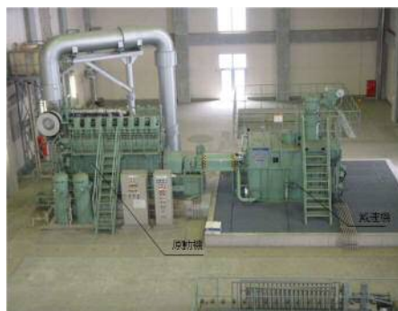
【主原動機・減速機(手城川排水機場)】
