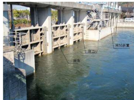
【吐出樋門(手城川排水機場)】
