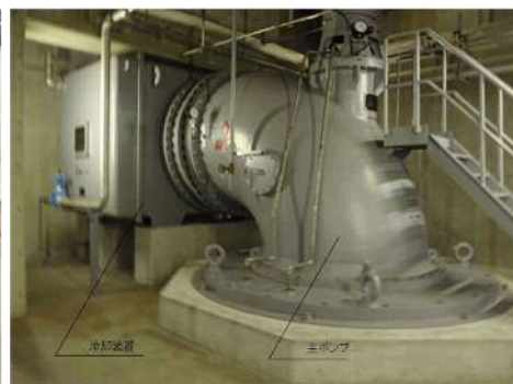
【主ポンプ・冷却装置(岡ノ下排水機場)】
